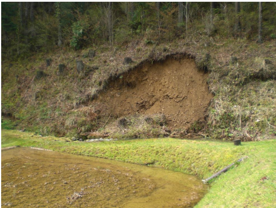
市内で発生した崖崩れ
