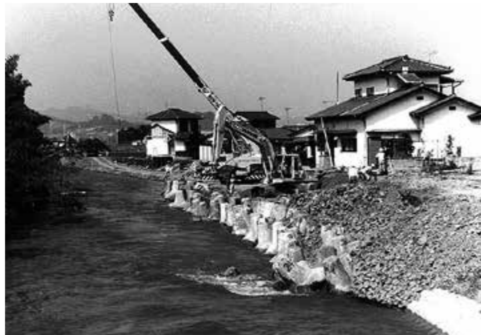
台風13号の影響で大北川が決壊。住宅7棟が被害を受けた (平成元年)
