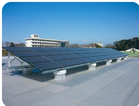
精華小学校に設置された太陽光発電システム
